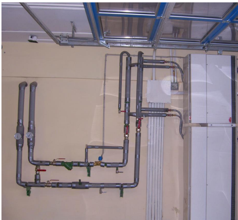
Рисунок 8 – Фрагмент установки воздушно-тепловой завесы
