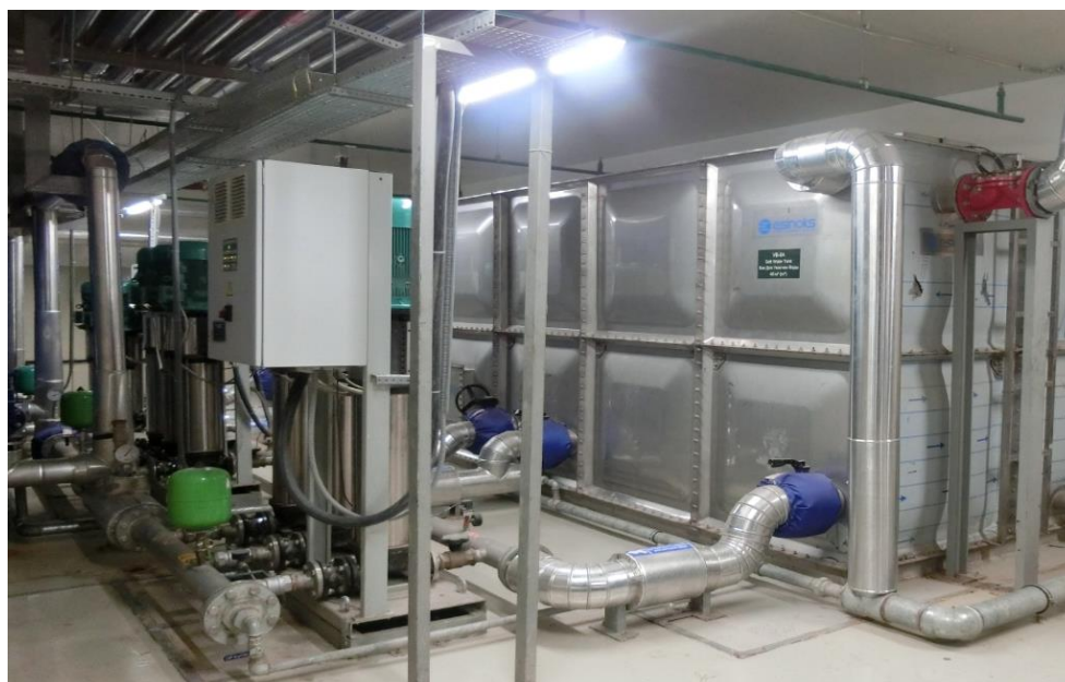
Рисунок 19 – Автоматическая станция пожаротушения с резервуарами воды
